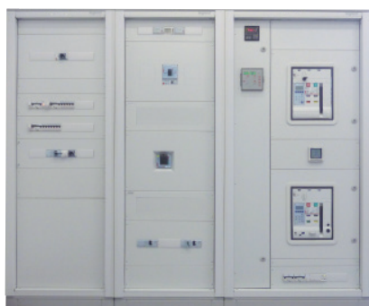
Conjunto de 4000 A con inversor de redes DMX 3 en el extremo de alimentación
