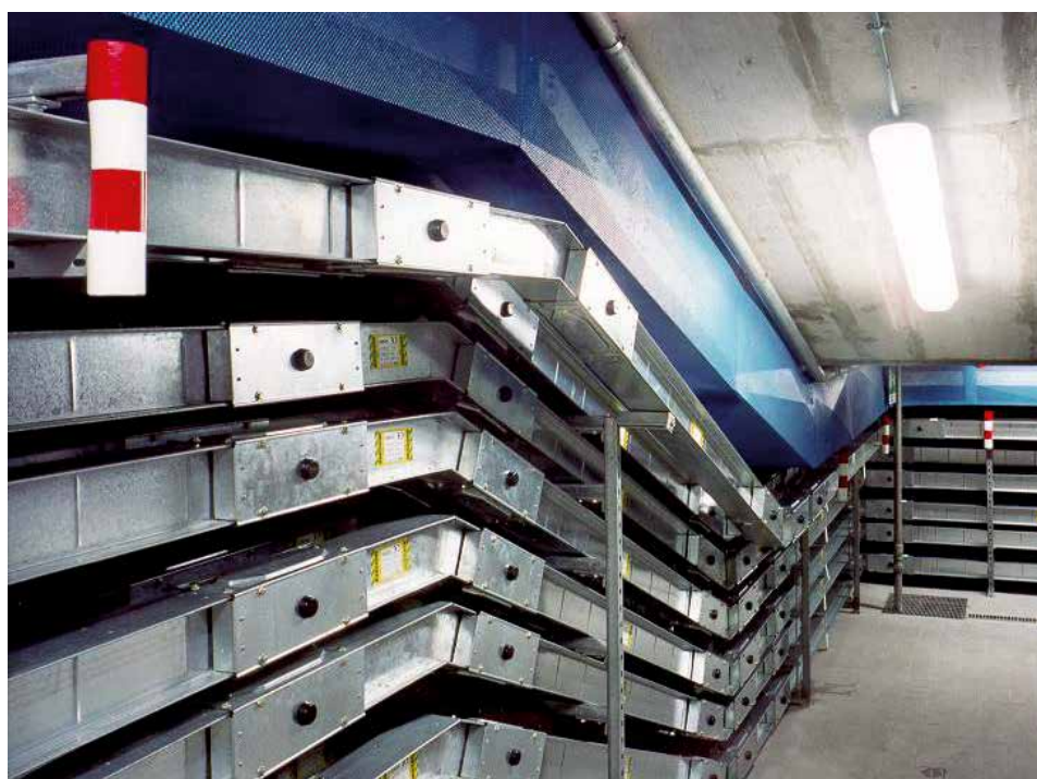
Ejemplo de distribución de alta potencia
